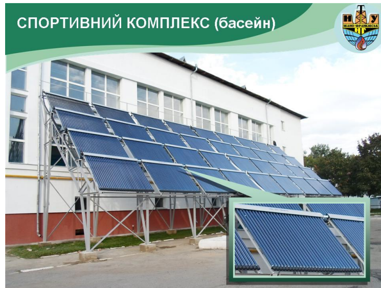
Рис. 6. Сонячна теплова станція
